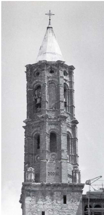
Torre de la iglesia parroquial de Fuentes de Jiloca (Zaragoza), antes y después de la restauración.
